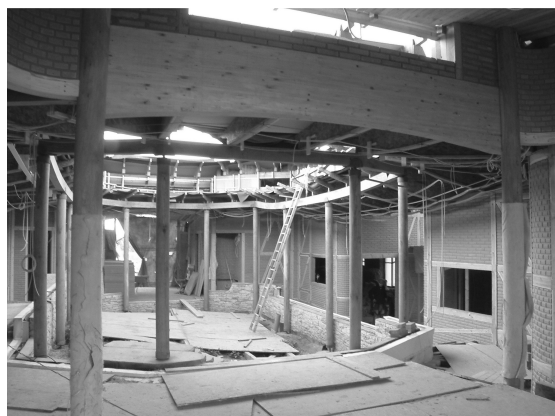
Obr. 6. Pohled do rozestavěného atriového domu směrem k vnitřní zahradě. Konstrukci domu tvoří dřevostavba vyzdřená nepálenými cihlami.
